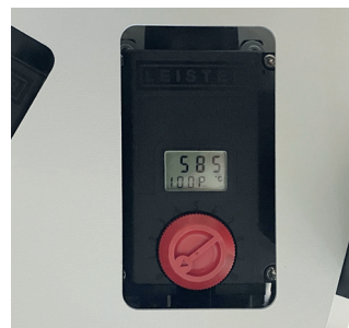
② AG107-Controlo de Temperatura Controlo da temperatura de ativação da cola
